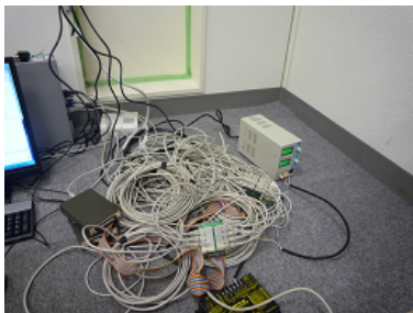
図 1: 知的照明システムの配線状況 (実際は床下に配置)
